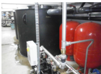
Cuves de stockage d'eau et pompes
