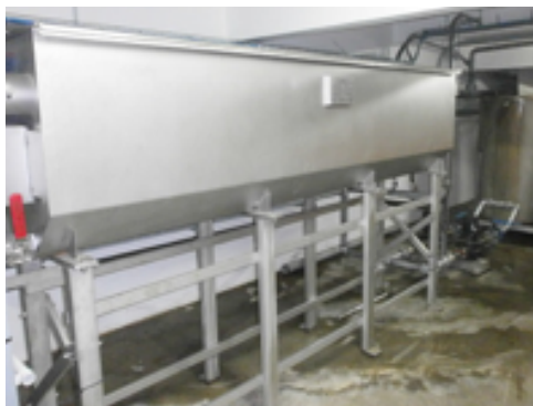
Echangeur de chaleur
